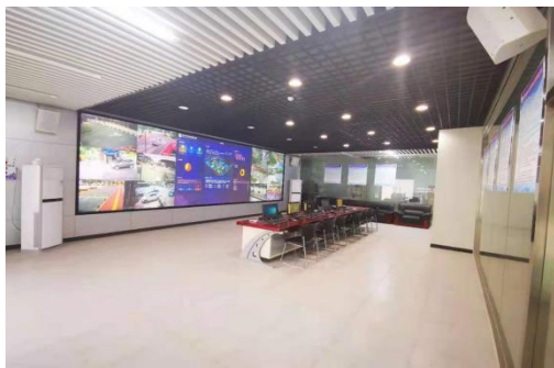
智慧校园中心监控室
